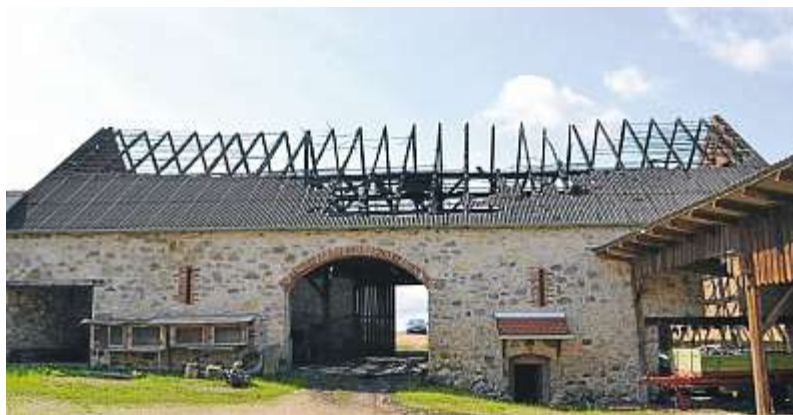
Nur noch ein Gerippe blieb vom Dachstuhl übrig. Die Mauern haben schon mehrere Jahrhunderte überdauert.
